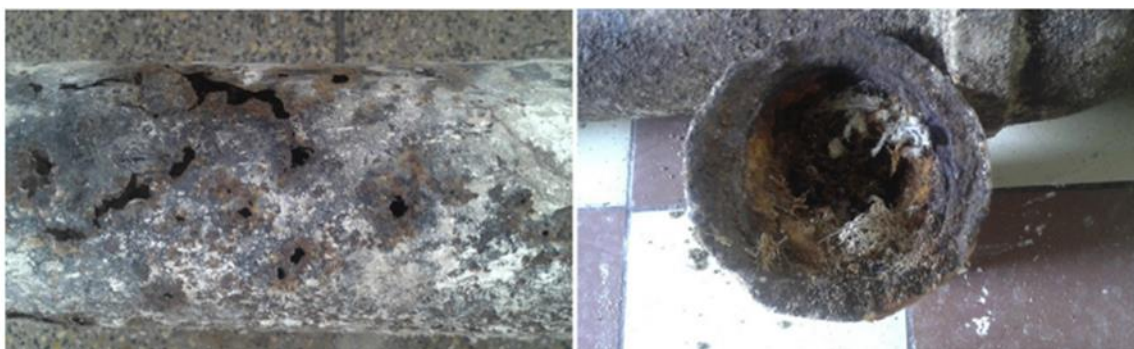
Slika 8. Primjeri učinaka korozije/biokorozije u cjevovodima [22].
