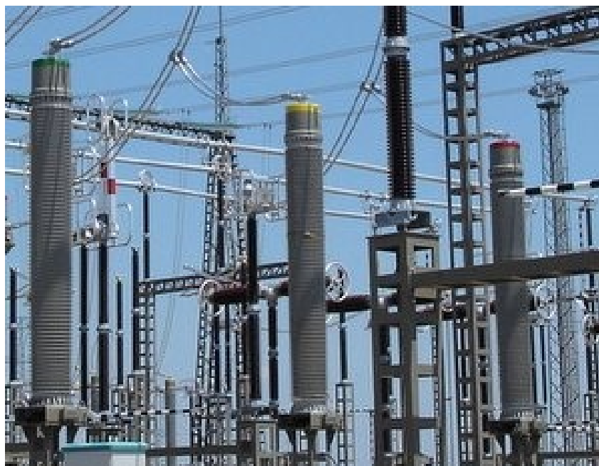
Slika 2.9 Visokonaponski mjerni transformator [19]
