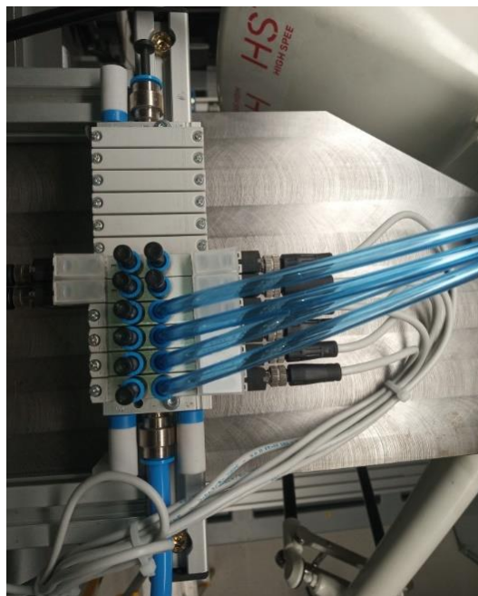
Slika 84. Prikaz instaliranog pneumatskog bloka s razvodnicima
