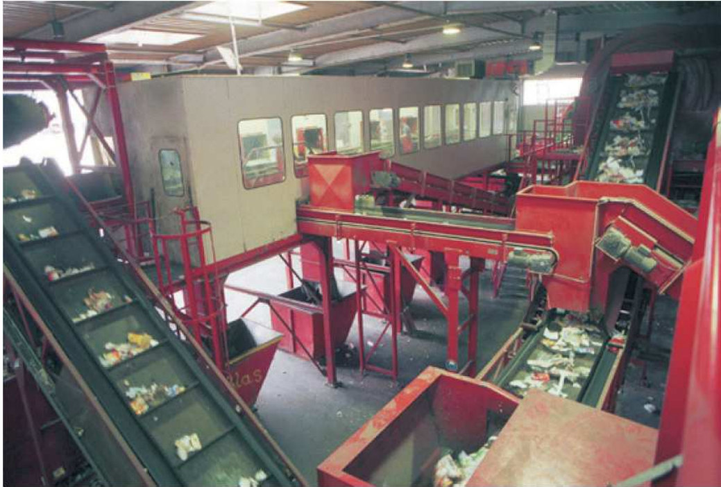
Slika 2.5. Postrojenje za preradbu komunalnog otpada u Njemačkoj [5]
