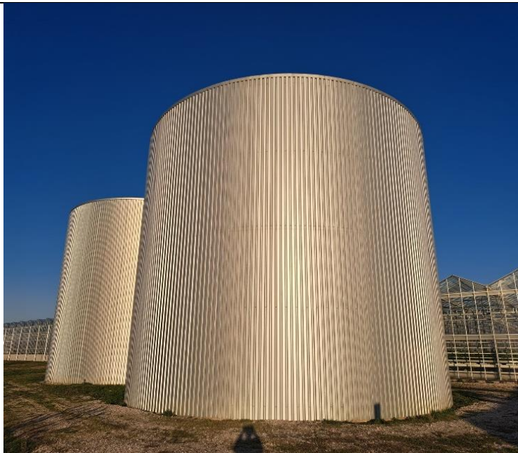
Slika 3-10: Dva toplinski izolirana buffer-a
