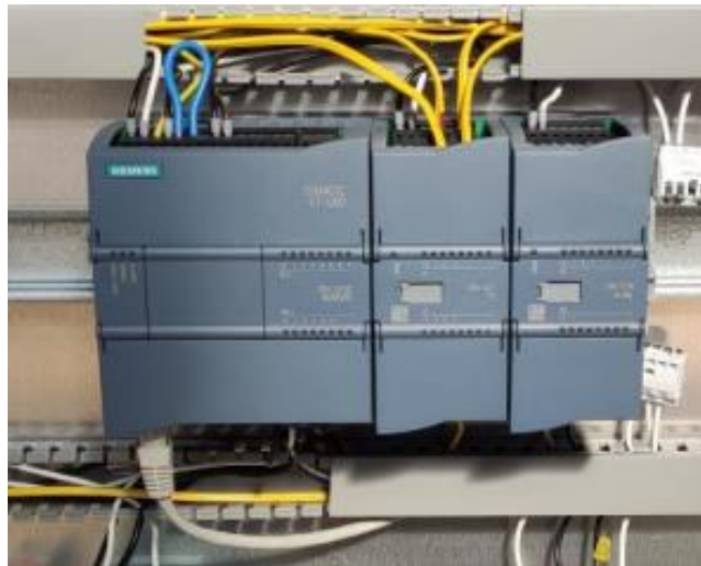
Slika 10. Upravljački Siemens PLC sustav s dodatnim modulima
