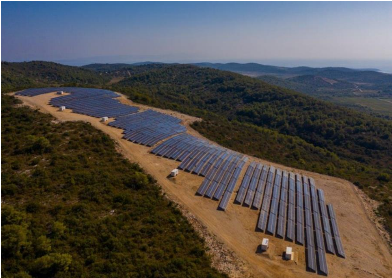
Slika 4 Solarna elektrana na Visu [5]
