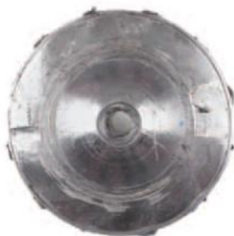
Slika 31. Oštećenja na rotoru kompresora
