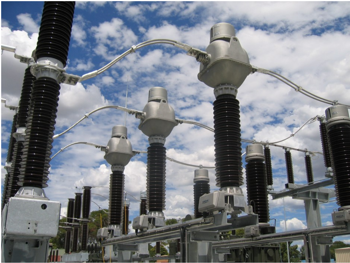
Slika 12. Mjerni transformator tipa AGU [7]
