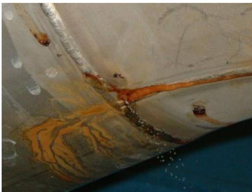
Slika 7. Propuštanje vode u području zavarenog spoja na čeliku AISI 304L izazvano korozijskim procesima uslijed mikrobiološkog djelovanja [10]
