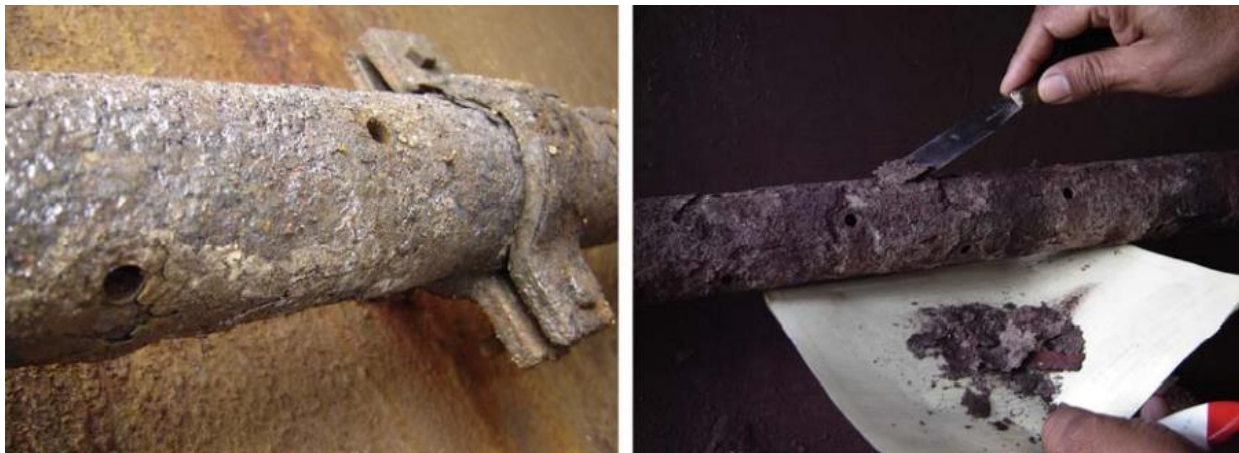
Slika 18. Korozija parne cijevi
