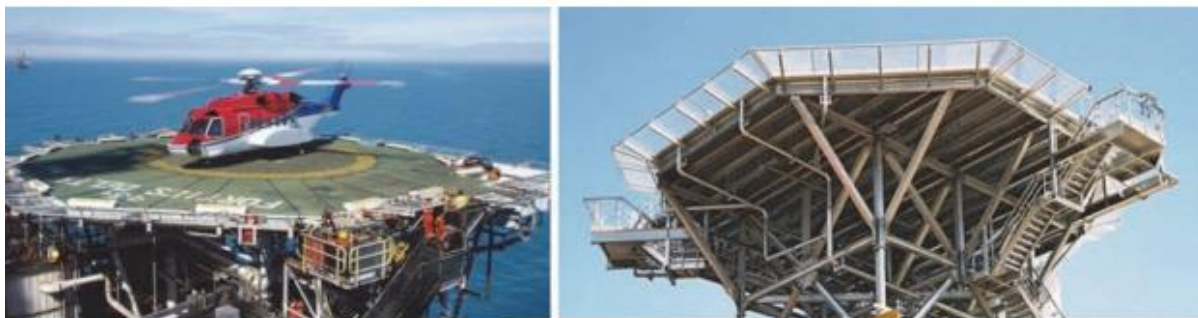
Slika 6. Platforme za helikoptere [4]
