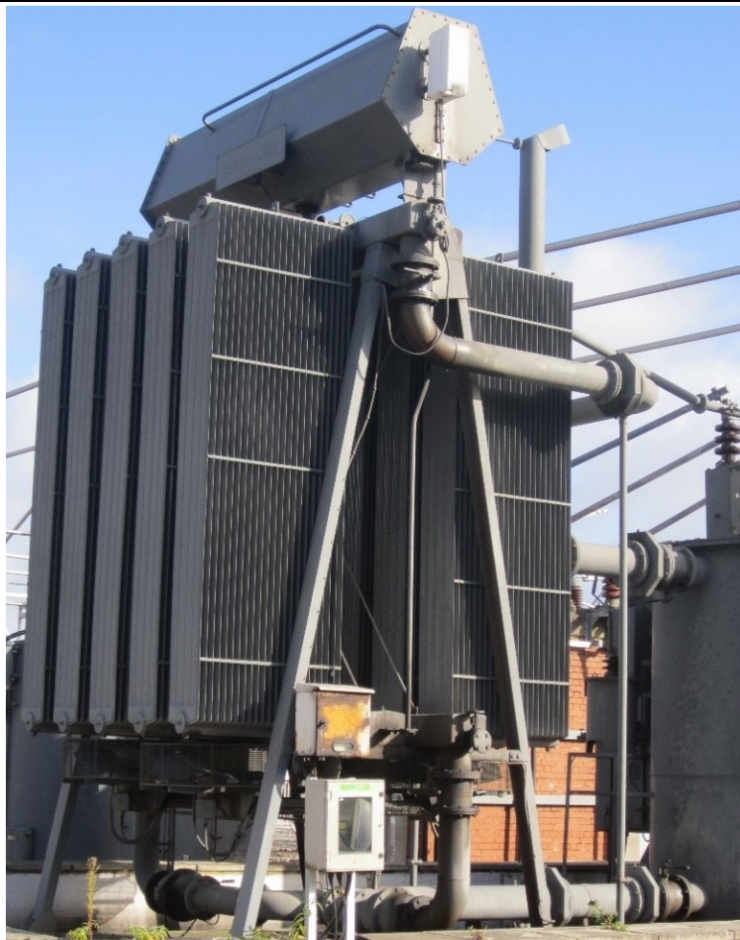
Slika 2.11 Odvojeni sustav za hlađenje transformatora 7 [10]
