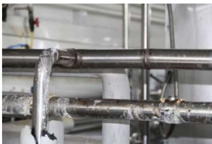
Slika 48. Korozijsko oštećenje te curenje sadržaja cijevi u pogonu za preradu mlijeka.
