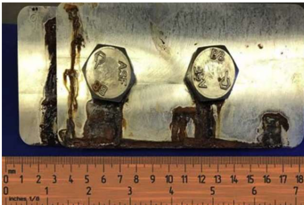
Slika 27. Korozija u procijepu preklopnog vijčanog spoja [18].
