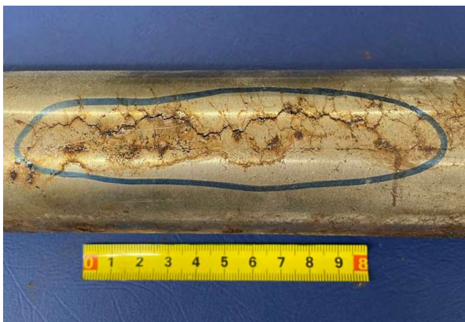
Slika 53. Otvorena pukotina na vanjskoj površini cijevi.
