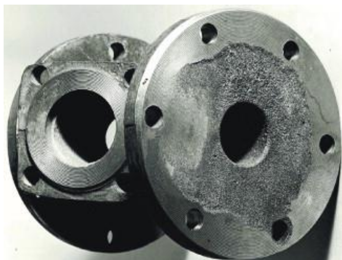
Slika 16. Primjer korozije u procjepu [21]
