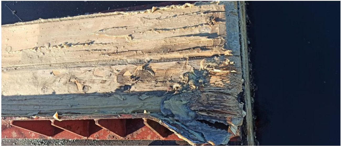
Slika 36. Prikaz oštećenja drvene podloge.
