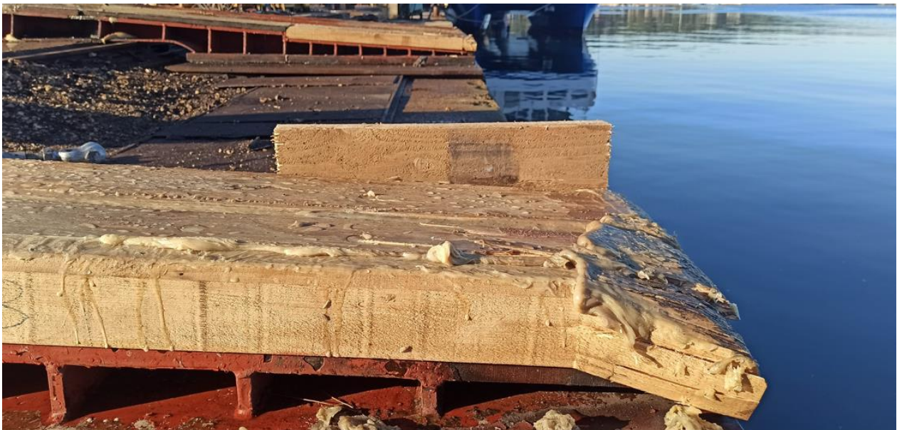
Slika 35. Prikaz oštećenja drvene podloge.
