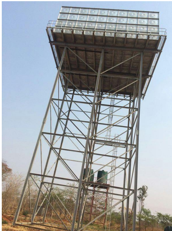
Slika 3. Spremnik za vodu napravljen od konstrukcijskog čelika [11]
