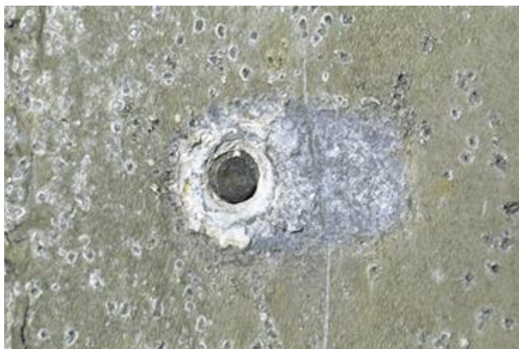
Slika 18. Galvanska korozija aluminija i čelika [24]
