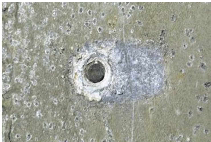
Slika 18. Galvanska korozija aluminija i čelika [24]
