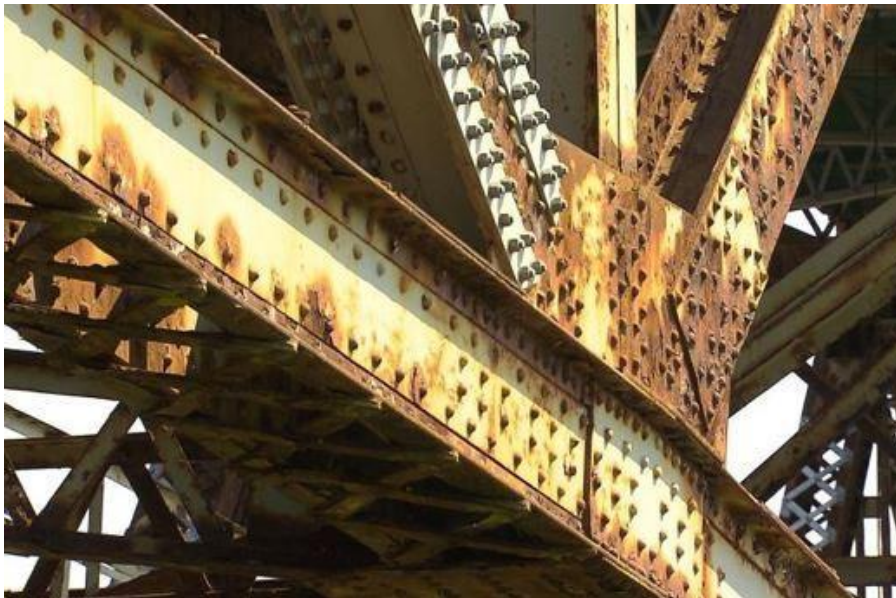
Slika 14. Atmosferska korozija čelične konstrukcije mosta [16]
