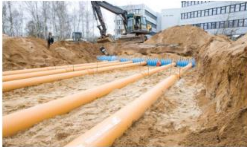
Slika 1. Primjer sustava s izmjenjivačem topline zemlja-zrak kod sjedišta tvrtke REHAU, Erlangen, Njemačka [3]
