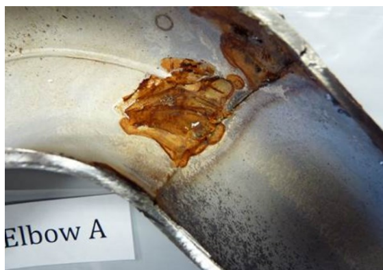
Slika 8. Korozija u procjepu čelika [15]
