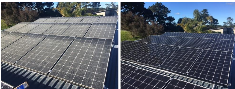
Slika 1.6. Prljave i očišćene solarne ploče [20]
