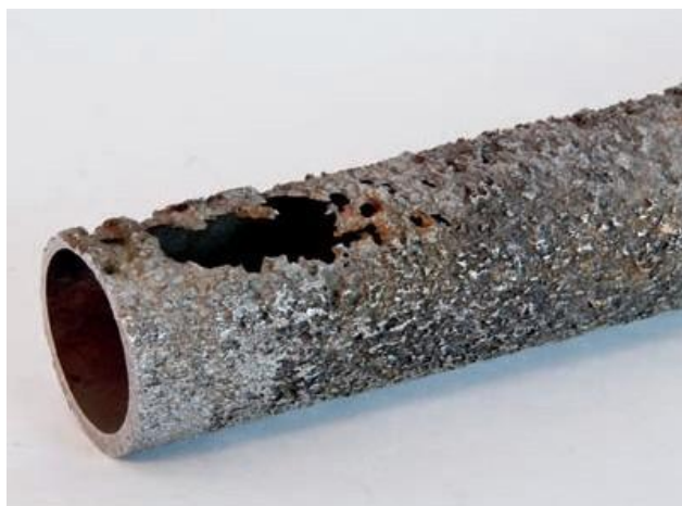
Slika 16. Opća korozija nehrđajućeg čelika uzrokovana sumpornom kiselinom [2]
