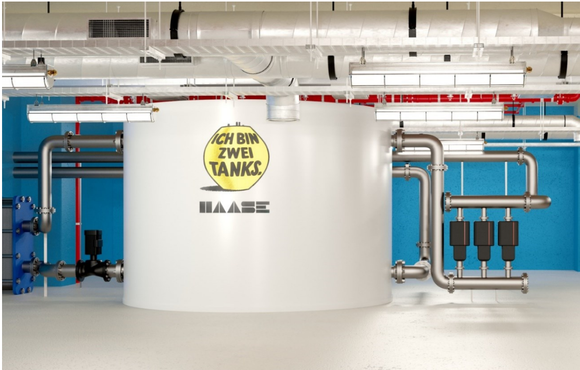
Slika 33. Akumulacijski spremnik vode
