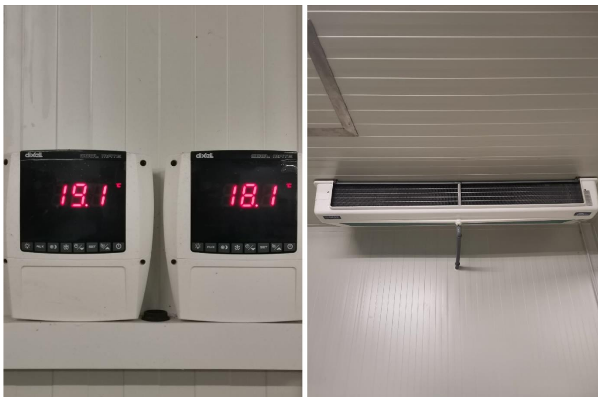
Slika 14. Rashladni uređaj i kontroler u vinariji Jagunić
