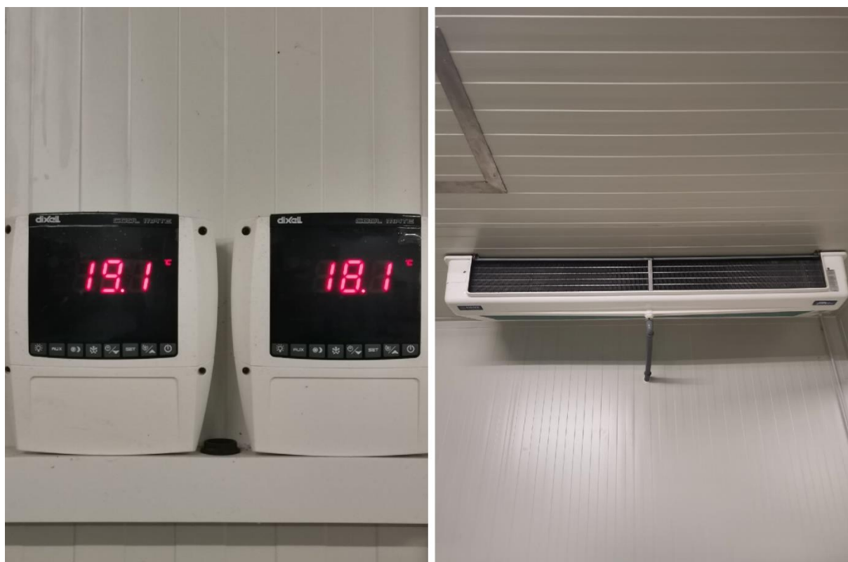
Slika 14. Rashladni uređaj i kontroler u vinariji Jagunić
