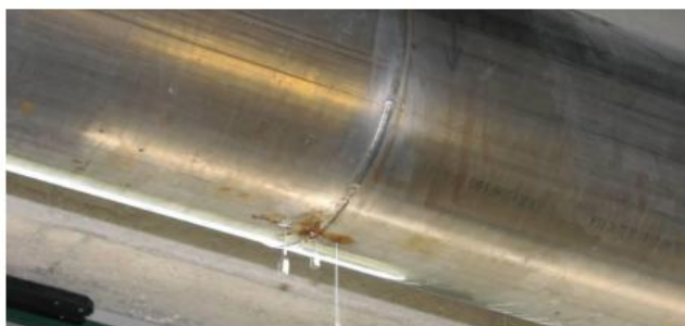
Slika 21. Propuštanje vode u području zavarenog spoja čelika EN 1.4307 izazvano MIC-om [12]
