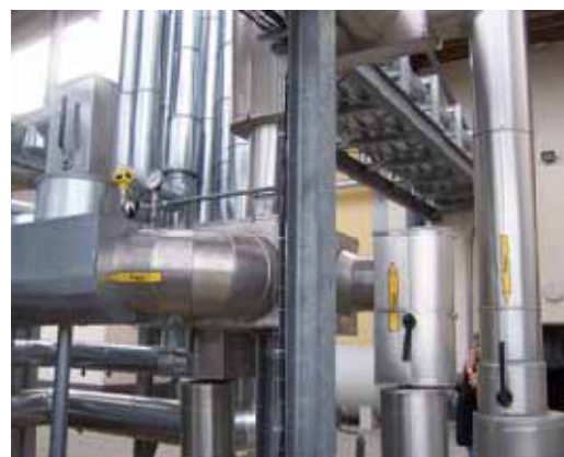
Slika 2.26. Izolirane cijevi za plin
