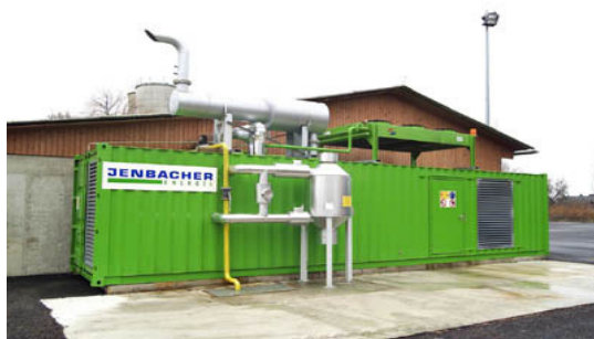
Slika 5.3. Vanjska ugradnja kogeneracijske jedinice
