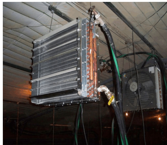
Slika 4.5. Izmjenjivači topline sa ventilatorima
