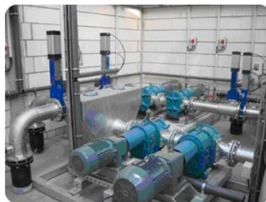
Slika 2.20. Sustav za pumpanje
