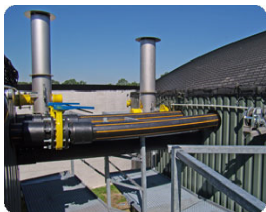
Slika 2.25. Sigurnosni ventil na plinovodu
