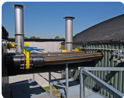
Slika 2.25. Sigurnosni ventil na plinovodu
