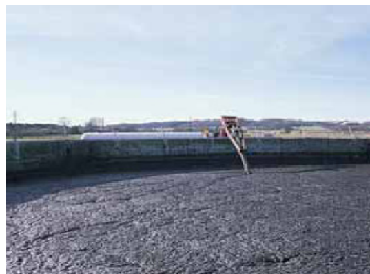
Slika 2.35. Spremnik za skladištenje digestata
