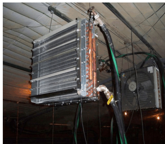
Slika 4.5. Izmjenjivači topline sa ventilatorima
