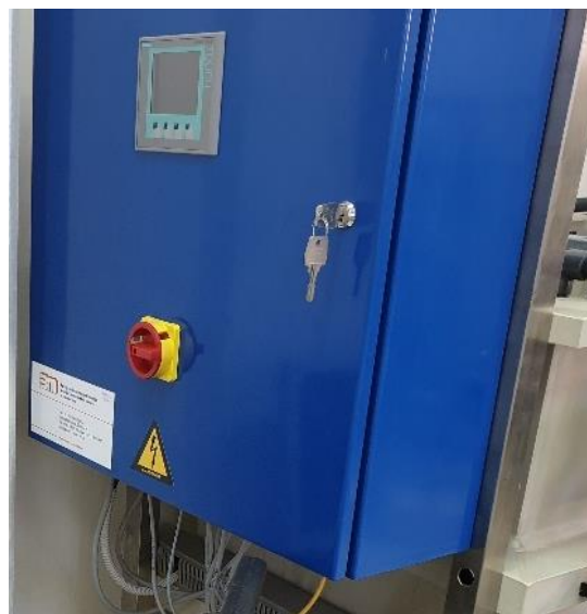
Slika 19. Električni ormar s PLC uređajem
