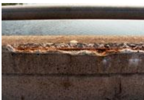
Slika 13. Korozija čelične armature u betonu [20]
