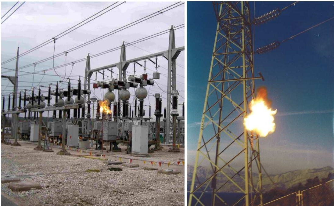
Slika 2-4-6-4 Namjerno izazvani preskoci u postrojenju i na dalekovodu u svrhu ispitivanja (izvor: arhiva Instituta za elektroprivredu i energetiku d.d. Zagreb)
