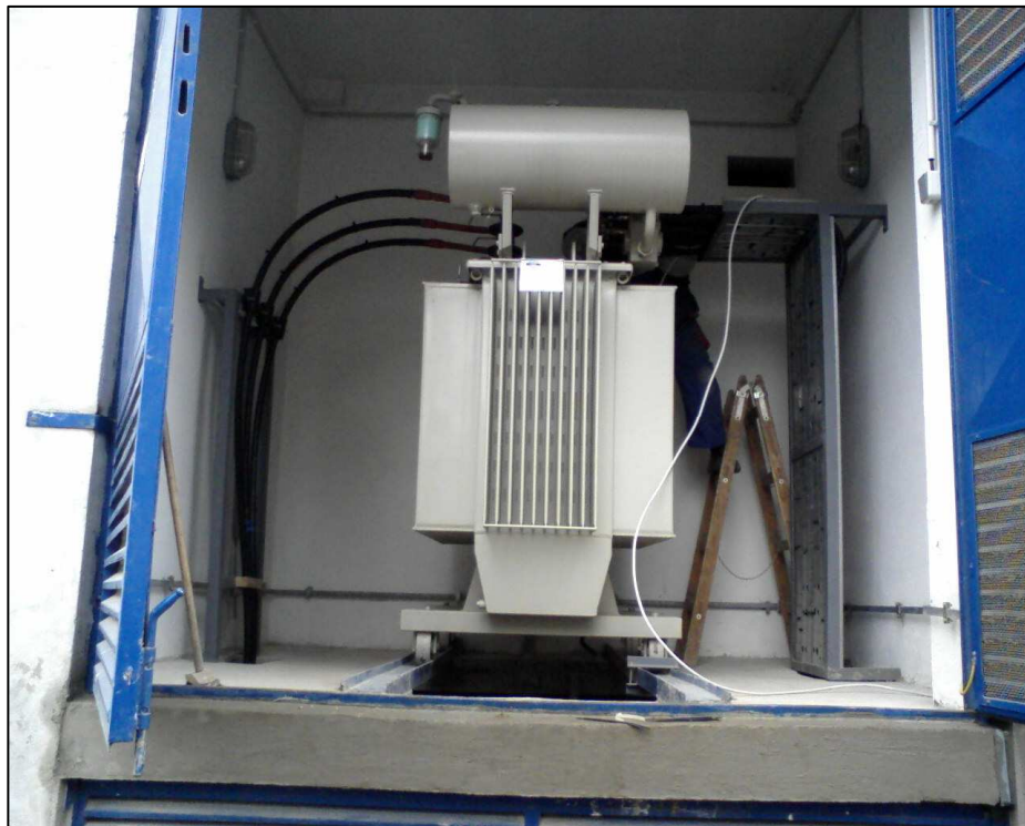
Slika 5-2-1: Distributivni transformator u trafo boksu (arhiva Instituta za elektroprivredu i energetiku d.d, Zagreb)
