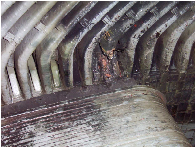
Slika 2-4-6-3 Međuzavojni kratki spoj na namotu generatora (izvor: arhiva Instituta za elektroprivredu i energetiku d.d. Zagreb)
