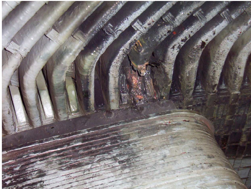
Slika 2-4-6-3 Međuzavojni kratki spoj na namotu generatora (izvor: arhiva Instituta za elektroprivredu i energetiku d.d. Zagreb)
