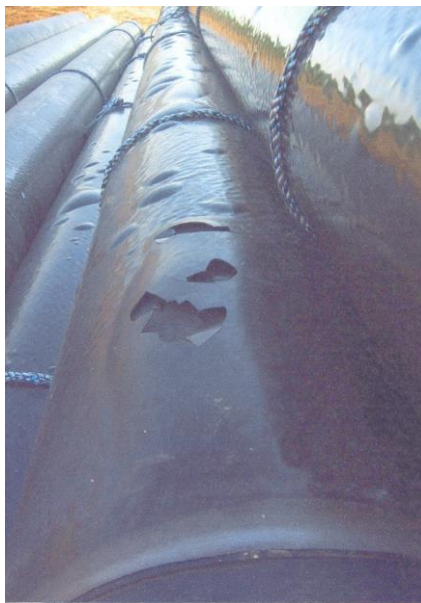
Slika 8.6 Deponija cijevi za plinovod Platforma Ivana K – Pula ( Kopneni dio ) Tvornička izolacija se na nekim mjestima napuhavala na suncu ( poliuretan – jednoslojni debljine 2 mm) [35]
