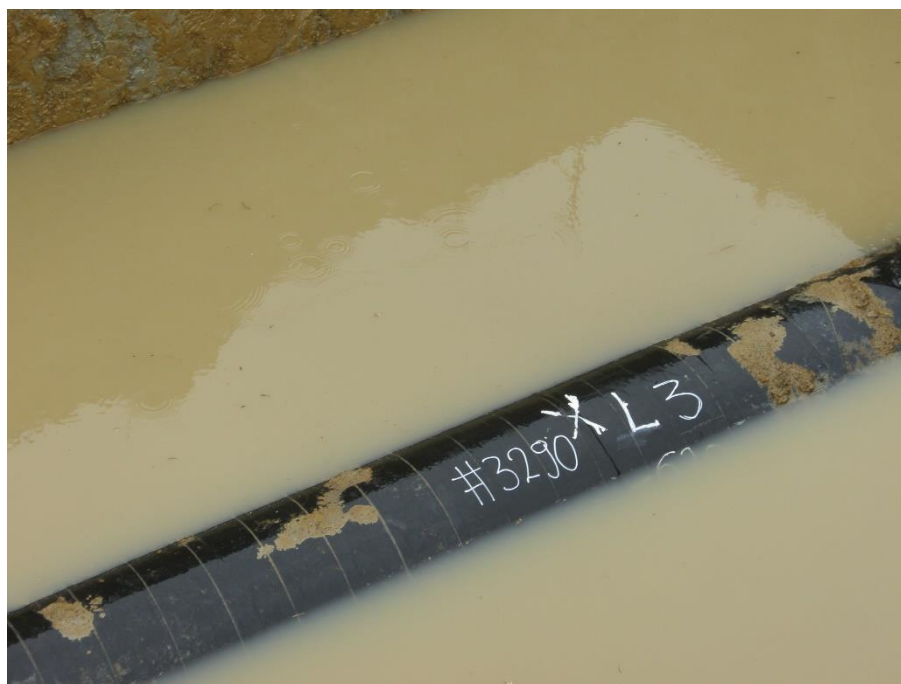
Slika 9.9 Punjenje iskopanih rovova vodom zaostalom u okolnom tlu nakon višednevnih kišnih dana [33]
