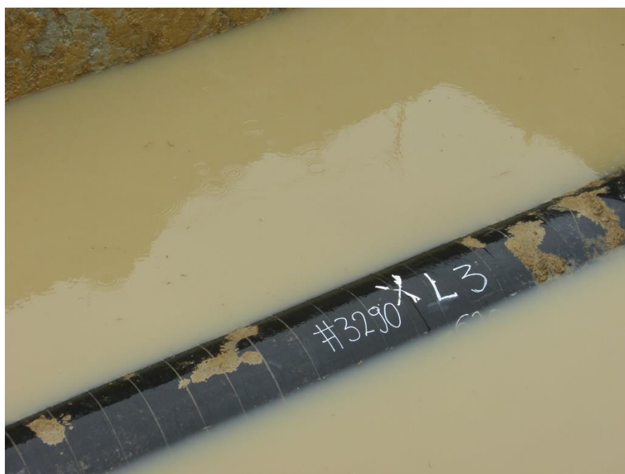
Slika 9.9 Punjenje iskopanih rovova vodom zaostalom u okolnom tlu nakon višednevnih kišnih dana [33]
