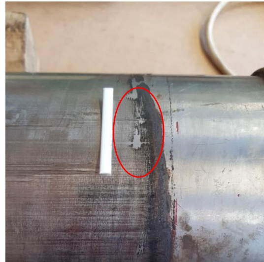
Slika 24. Segment A, hrapava površina, pukotina s gornje strane
