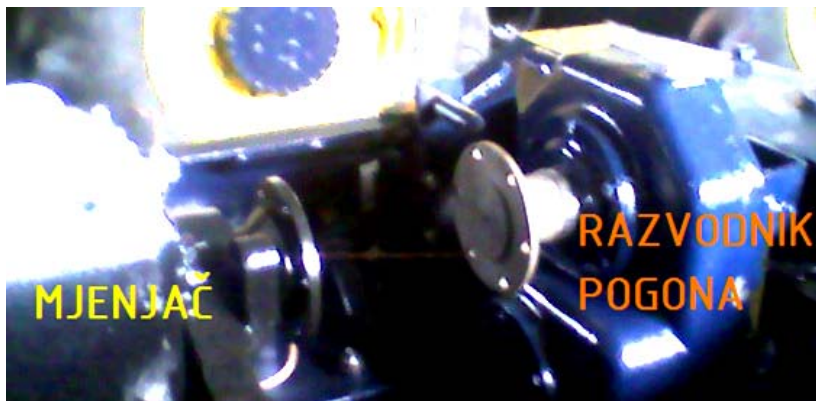
Slika 31: Smještaj razvodnika pogona u šasiji – pogled od strane mjenjača
