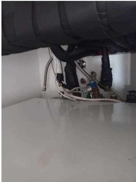
Slika 22. Odspojeni spojevi pri zamjeni nipli
