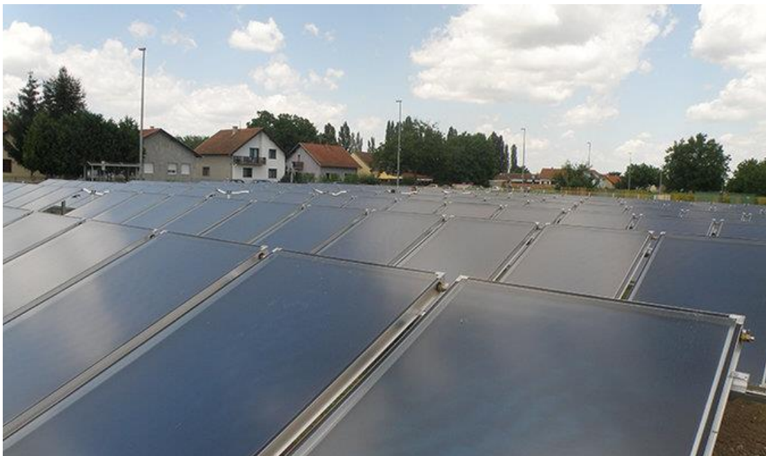
Slika 10. Polje solarnih kolektora u Vukovaru [18]
