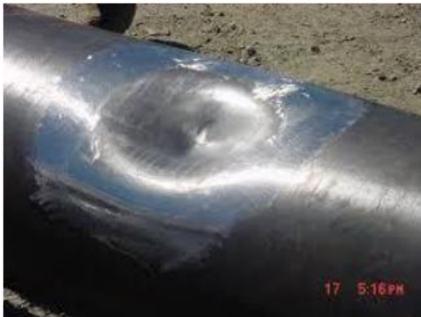
Slika 2.10. Primjer udubljenja cijevi [9]
