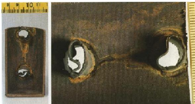
Slika 2.6 Primjer puknuća cijevi zbog djelovanja kontaktne korozije [5]
