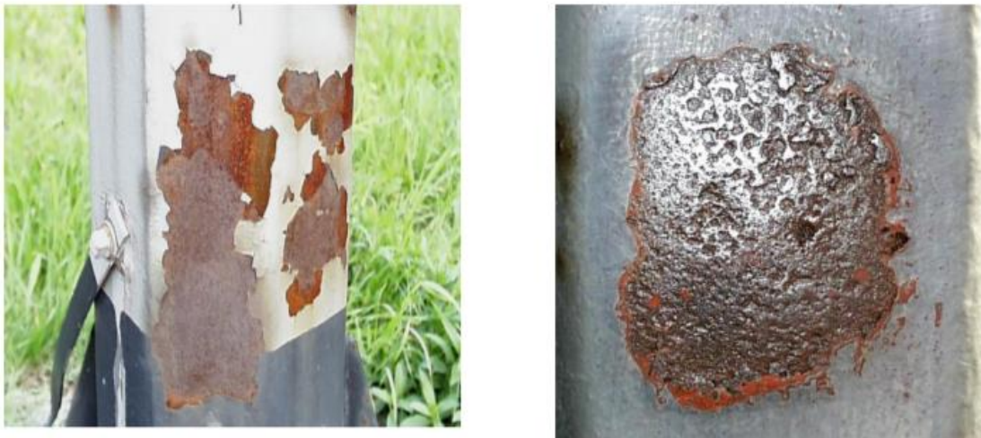
Slika 3: Prikaz ravnomjerne i neravnomjerne opće korozije [5]
