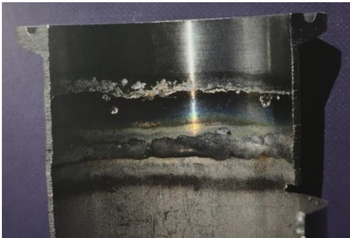
Slika 17: Rupičasta korozija na pobojenoj površini cijevi [29]
