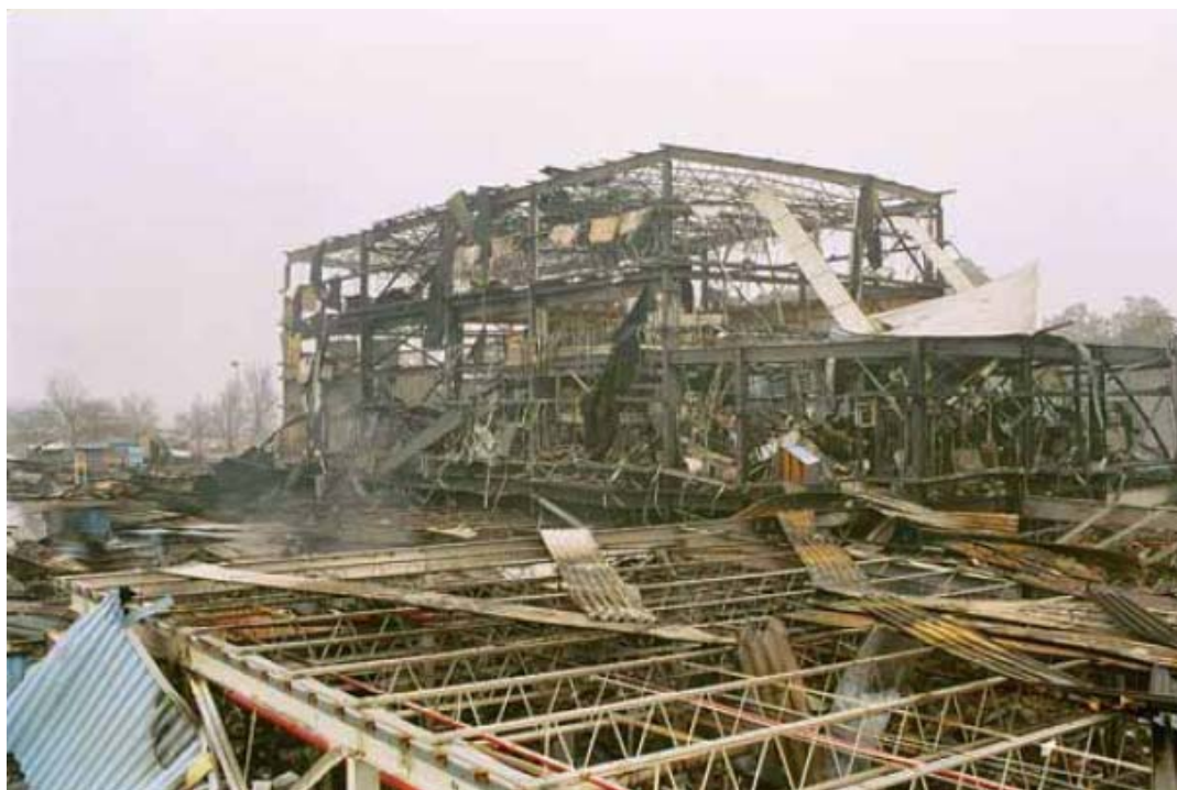
Slika 2.15 Posljedica eksplozije prašine polietilena u “West Pharmaceutical Services, Inc” Kinston, North Carolina [15]
