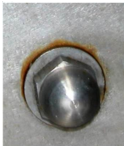
Slika 15. Primjer korozije u procjepu [16]
