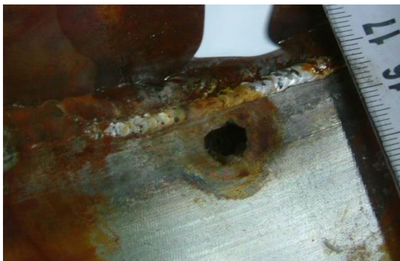
Slika 32. Rupičasto oštećenje zavarenog spoja ispod uklonjenih nakupina biofilma na čeliku EN 1.4307 [33]
