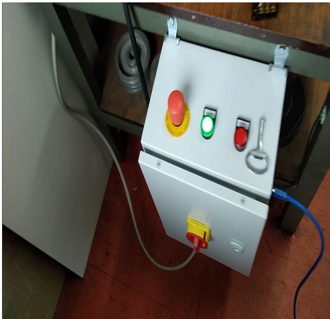
Slika 36. Montiran razvodni ormar
