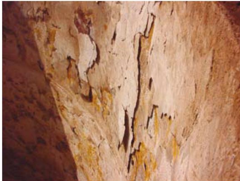
Slika 10. Unutrašnjost čeličnog dimovoda oštećenog korozijom [13]
