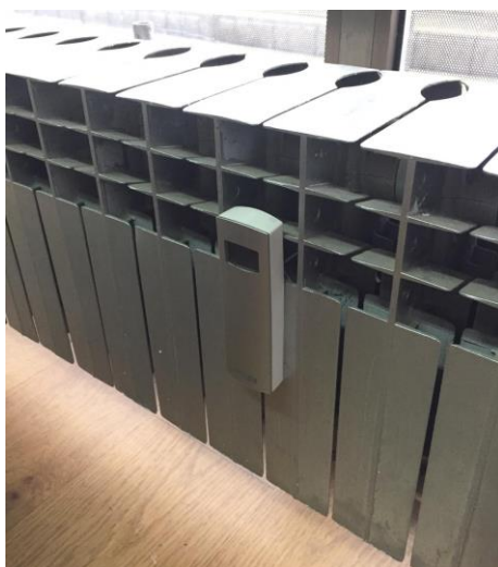
Slika 1-2 Razdjelnik troškova toplinske energije na radijatoru
