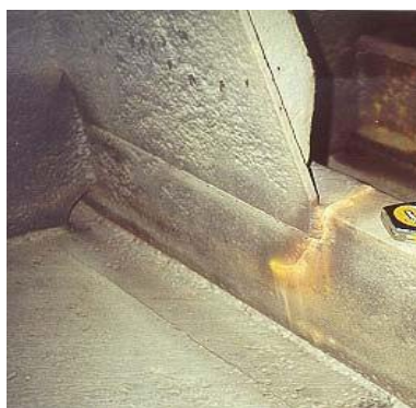
Slika 2.6 - Otkrivena zamorna pukotina magnetnim česticama na spoju koljena i uzdužnjaka dna [6], [26].
