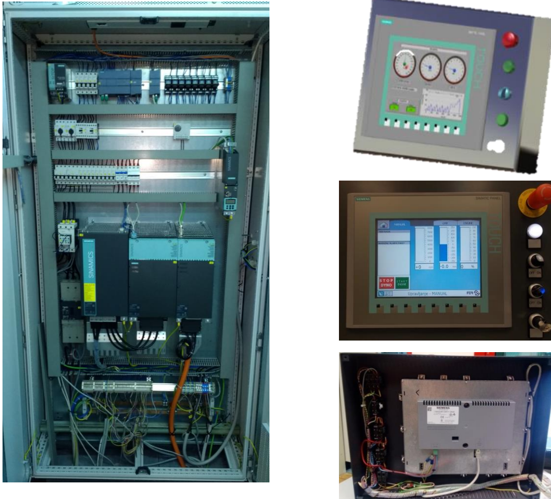
Slika 2.17. Upravljački ormar kočnice (lijevo) i HMI (desno)
