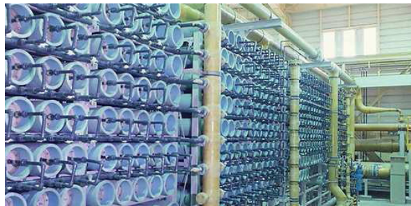
Slika 10. RO moduli u postrojenju za desalinizaciju
