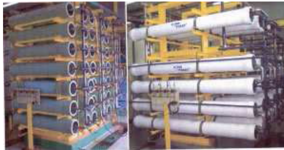
Slika 9. RO moduli u postrojenju za desalinizaciju
