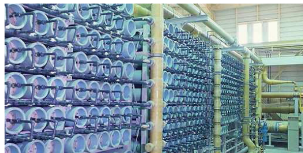
Slika 10. RO moduli u postrojenju za desalinizaciju
