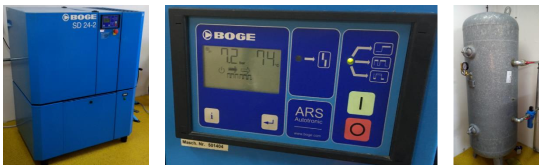
Slika 2.23. Sustav za nabijanje zraka – kompresor BOGE SD 24-2 i spremnik stlačenog zraka
