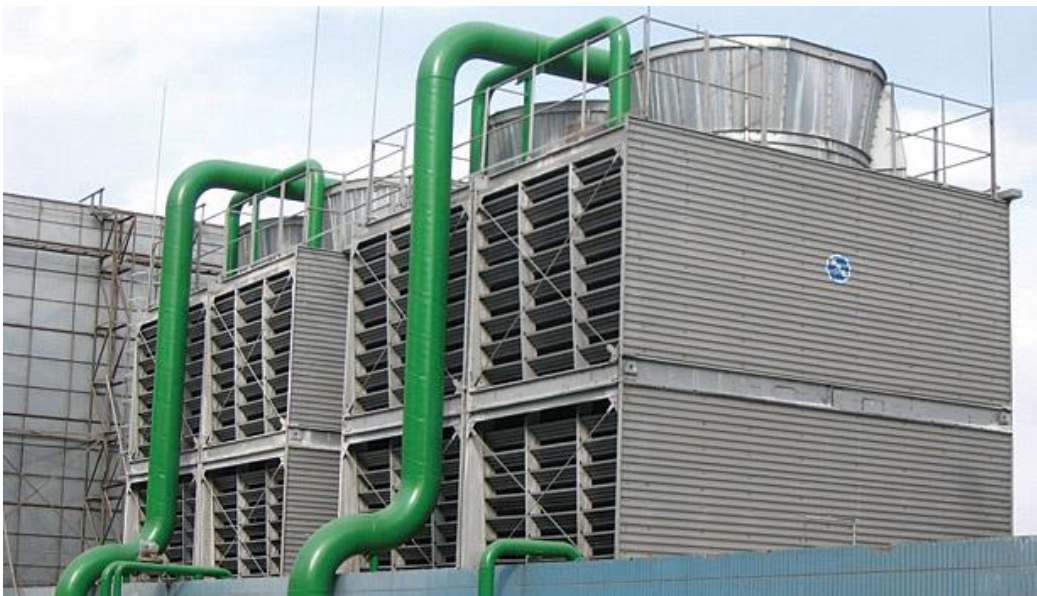
Slika 13. Rashladni toranj izrađen od galvaniziranog čelika
