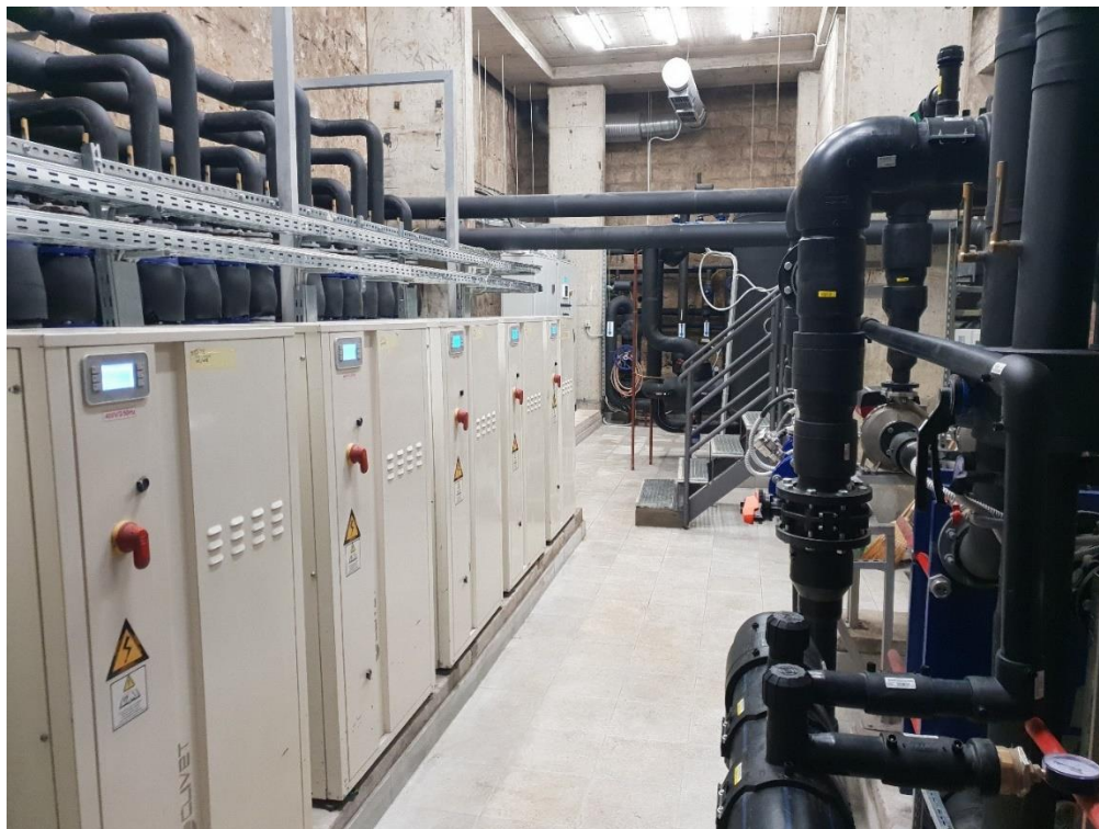
Slika 18. Postrojenje sustava dizalice topline morska voda - voda, Knežev dvor, Dubrovnik [14]
