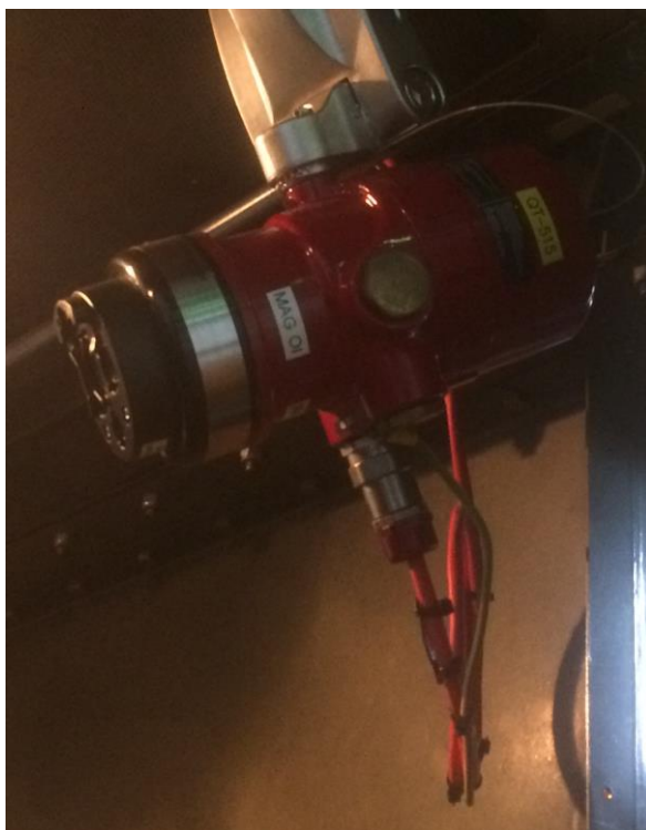
Slika 26. Kamera za detekciju požara
