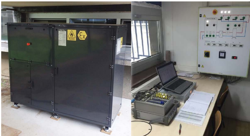
Slika 4-3 Dizalica topline s integriranim hidrauličkim modulom (lijevo) te akvizicijski sustav i elektro-regulacijski ormar u Tehničkoj sobi (desno)
